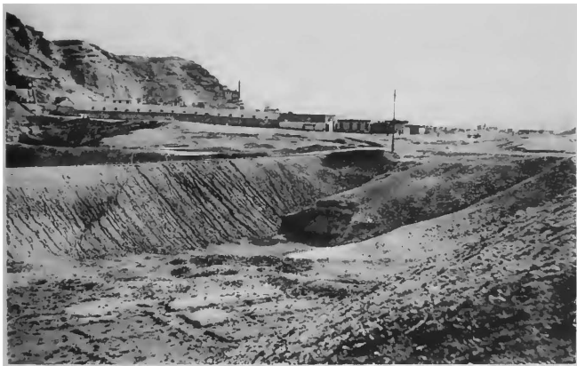
1 - Effets directs de la pluie sur une digue du chemin de fer
